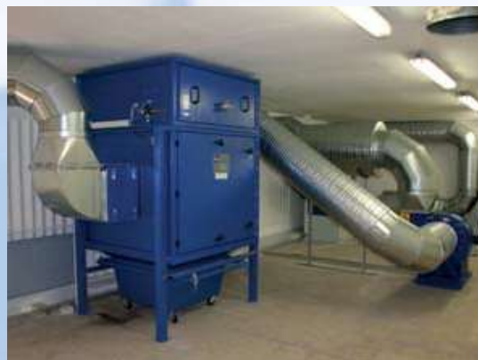
ZPF bei niedriger Deckenhöhe
